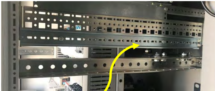
EXISTING DIN RAIL
